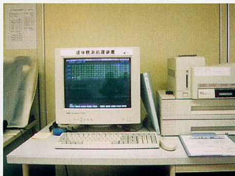
堤体観測処理装置
