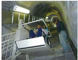
▲C 一般開放の階段部には、バリアフリー対応として昇降機を設置しています。
